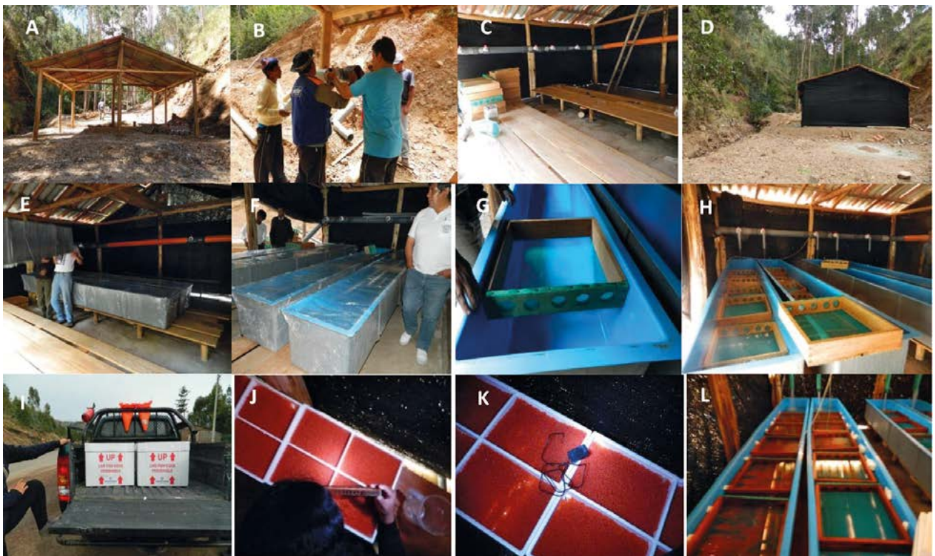
Figura 5.- Módulo de Socos. A) Construcción del módulo prefabricado. B) Instalación de tuberías para ingreso del agua. C) Instalación de camas de madera para la colocación de tanques. D) Módulo prefabricado terminado. E) Ingreso de tanques al módulo. F) Tanques instalados. G) Canastillas para siembra de ovas embrionadas. H) Sistema listo para siembra. I) Llegada de ovas. J) Conteo de ovas. K) Medición de temperatura durante aclimatación de ovas. L) Siembra de ovas
