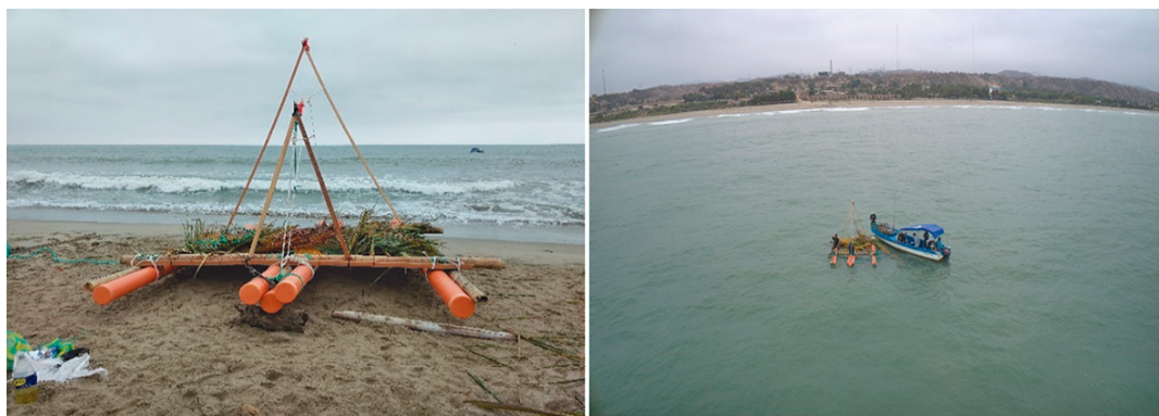
Figura 9.- Instalación y fijación del DCP modelo trimarán en playa Boca de Quebrada, Tumbes
