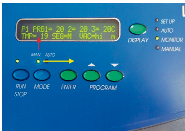
Figura 19.- Tablero de mando del Stoppering Tray Dryer Flecha roja= temperatura promedio de sensores Flecha amarilla= modo de funcionamiento del Stoppering tray dryer
